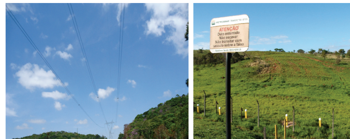
Figura 4 e 5: Rede de alta tensão da cemig e placa do oleoduto da petrobrás na área da rebio
